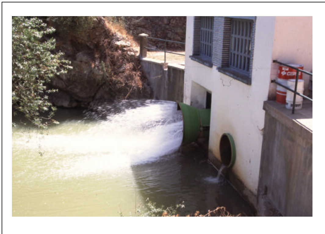
Foto 4. Vertido con válvula de chorro hueco en el río Huerva.
