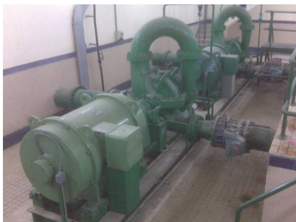
Sala de bombas (3x 800 CV)
