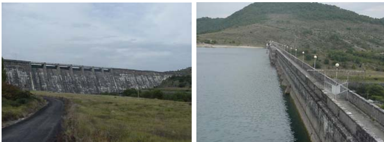
Vista del paramento aguas abajo (izq) y coronación desde aguas arriba (der)
