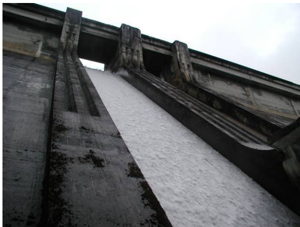
Vista de la rápida desde la pasarela de acceso al desagüe de fondo
