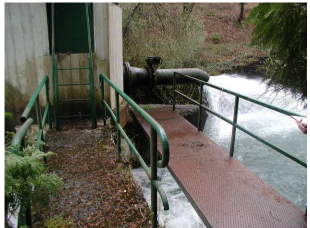
Vista del desagüe de fondo de la pasarela de acceso a la caseta
