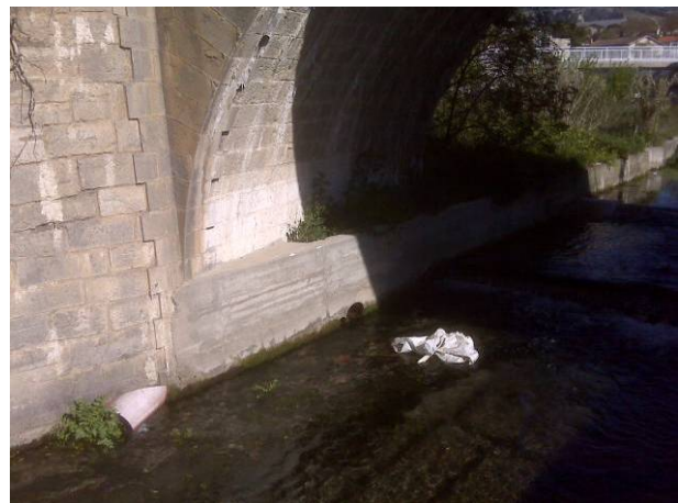
Vertidos aguas arriba de la toma
