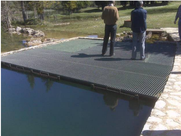
Bombas sumergidas (2x 56 kw)
