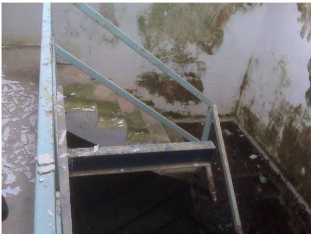
Sala de bombas inundada (4x340CV?)
