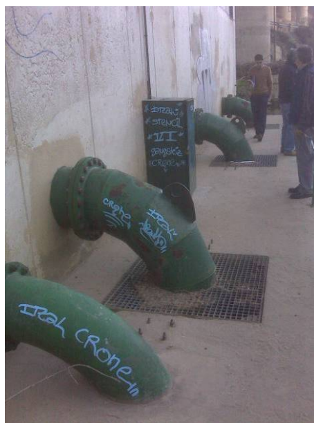
Aspiraciones de las bombas. En primer término, tubería de desagüe
