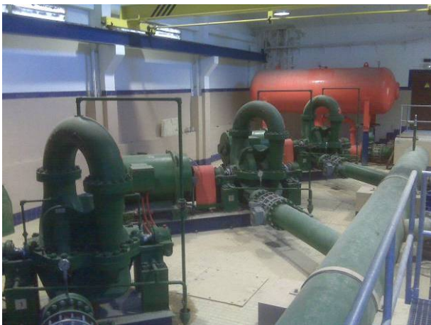
Sala de bombas(3x 800 CV) y colector de la impulsión. En segundo término, calderín
