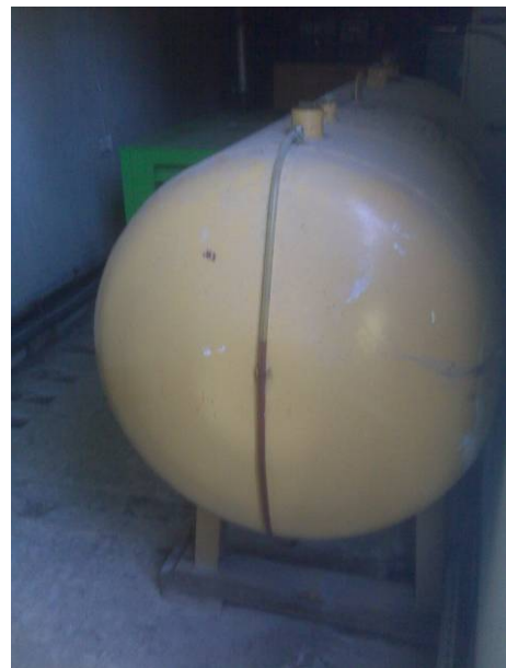
Depósito del grupo electrógeno
