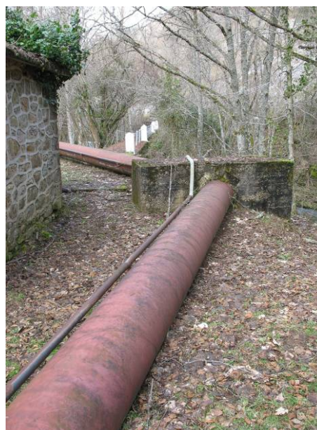
Conducción de emergencia
