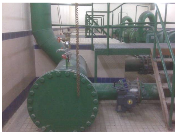
Brida ciega del colector de la impulsión y tubería de conexión con el calderín
