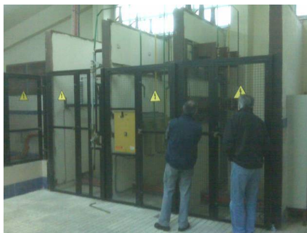
Alimentación eléctrica de los motores de las bombas
